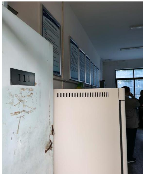
图 4 3L-111 室有漏电现象
