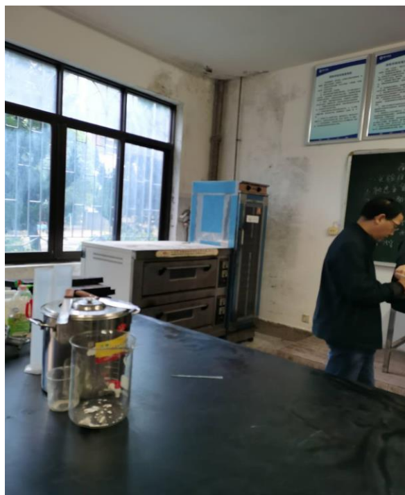
图 3 食品学院实验室漏水情况
