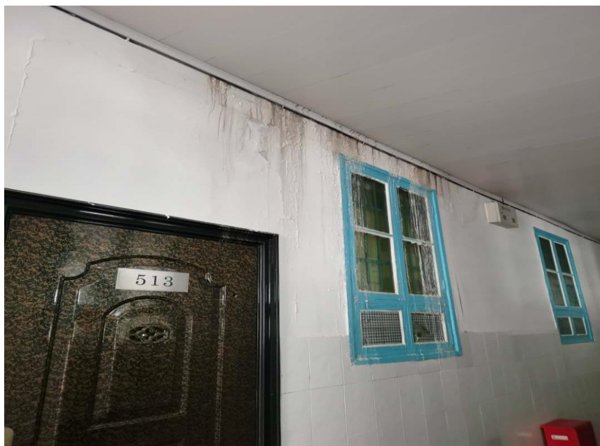
图 9 医学院西湖校区实验室漏水情况
