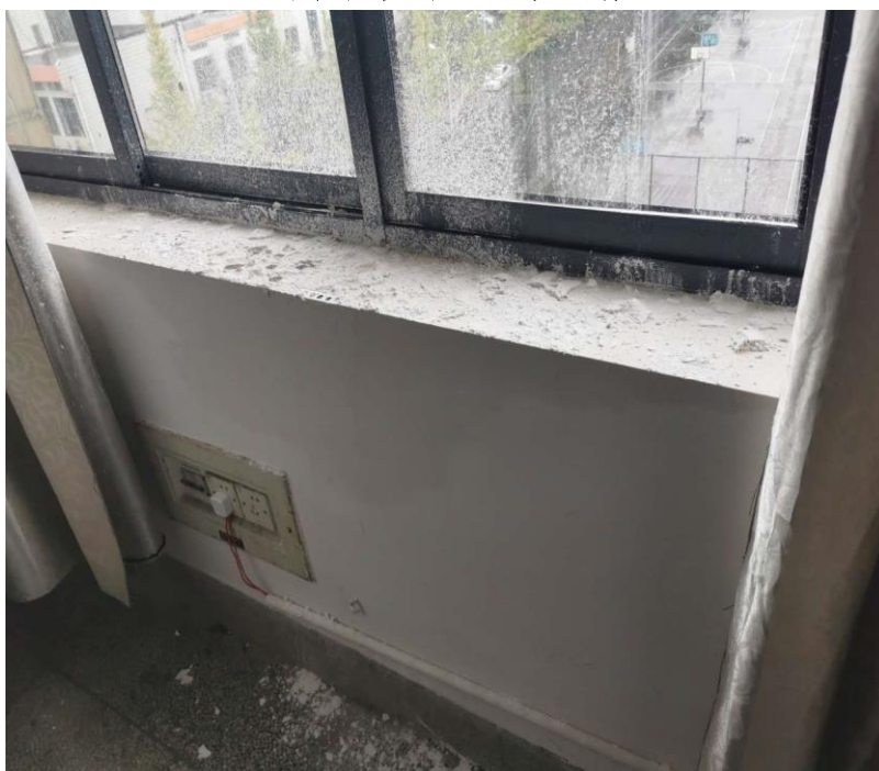
图 8 电气学院实验室漏水情况 (2)
