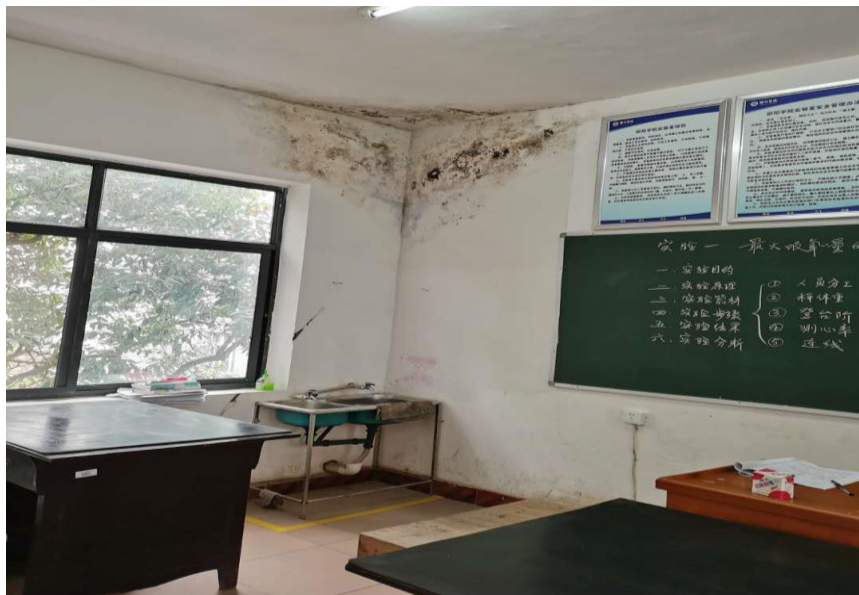
图 1 体育学院运动生理实验室漏水情况
